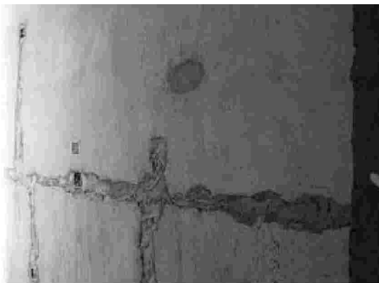
b)不规范施工
