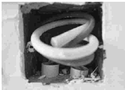
b) 底盒与电线管接头不规范施工
