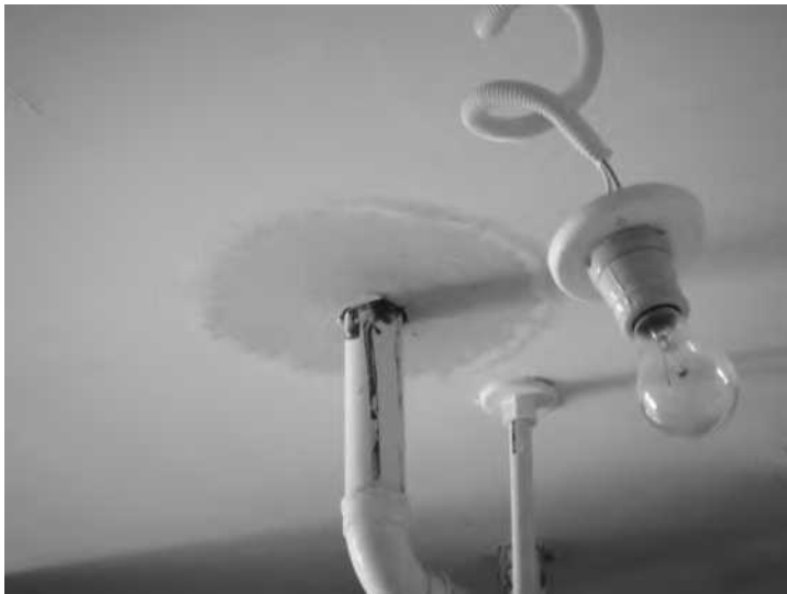
渗水印记表明防水失败
