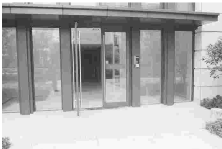
门框、门吸、闭门器和地弹簧齐全
