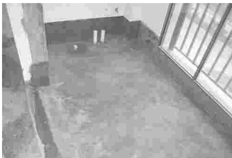
地漏应位于水管附近
