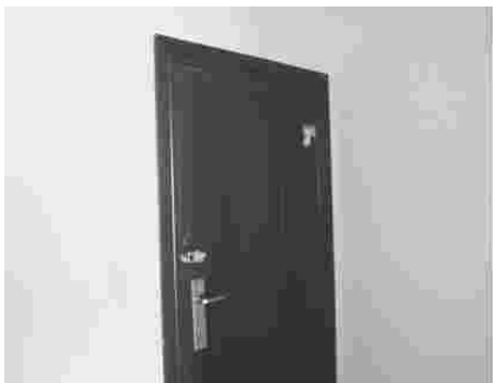
错误：入户门门套线安装在室内
