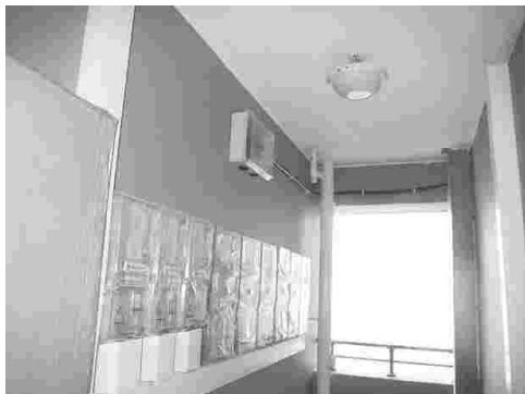
管线及表箱设置在公共走道
