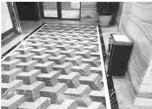
地面砖或石材粘贴牢固无缺损
