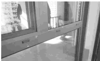
窗应设泄水孔，且孔盖安装齐全
