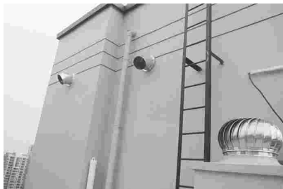
排风扇有防雨措施
