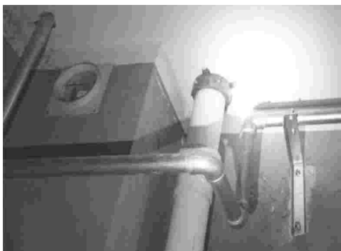
错误：燃气管道过低，影响厨房装修及布置
