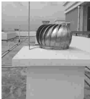
烟道和风道风帽安装牢固美观
