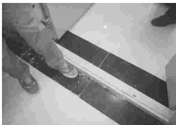
楼梯间防火门下部不应设门槛
