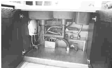
管道间隔距离过短，容易发生意外
