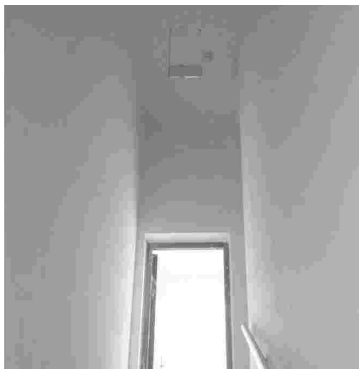
顶层楼梯间照明不宜设置在顶棚
