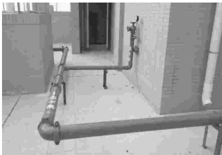
错误：上人屋面疏散通道被消防管道阻挡
