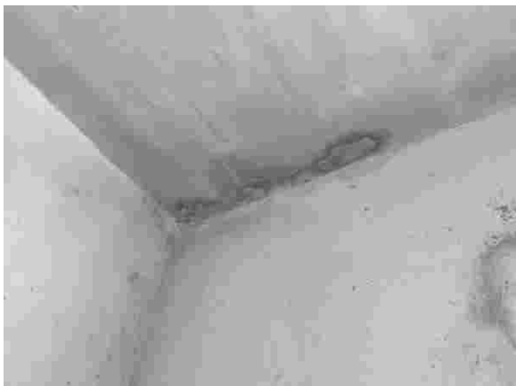
渗漏易出现在顶面的边角部位（二）
