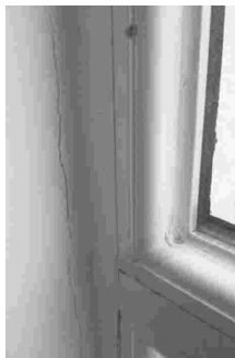
打胶和墙面腻子脱裂
