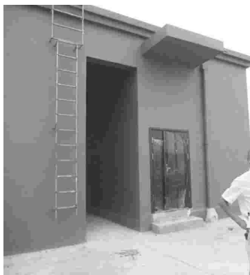
错误: 上人屋面爬梯设置过低, 且不美观
