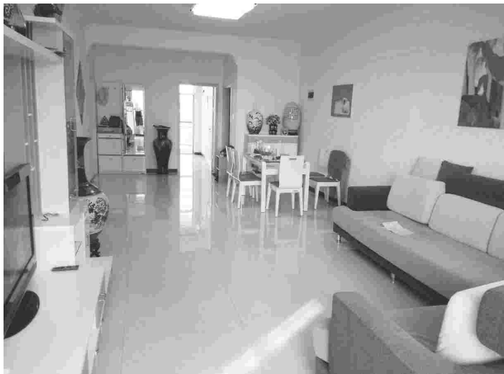
损伤较小的地面，若装修资金不足，可保留使用
