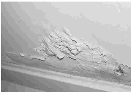
墙面脱皮、起泡
