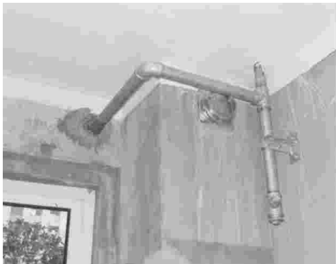
错误：管道的布设影响排风的使用
