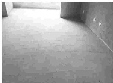
外观平整、无裂纹
