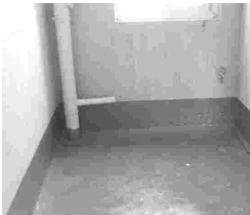
错误：排水管无向上弯头
