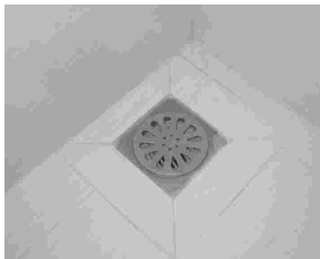
地砖或石材与地漏结合处严密牢固，无渗漏
