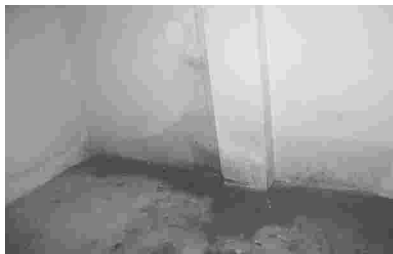
靠近外立面墙体的地面区域易出现渗水
