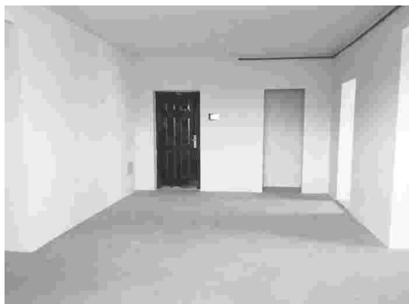
漆面无大面积脱落现象
