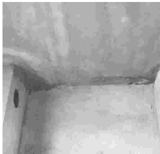
渗漏易出现在顶面的边角部位（一）
