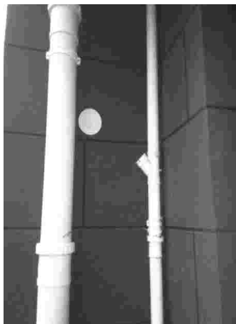
空调排水立管不得阻碍空调洞
