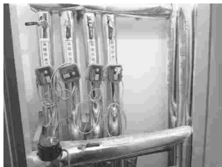
设备井内管道标识完整
