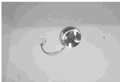
电梯机房内设置排风扇
