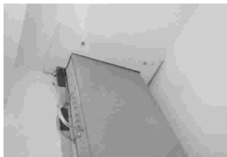
桥架周边封堵严密，采用专用防火材料进行密封
