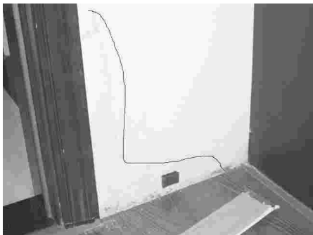
水渍颜色越深，说明渗漏越严重
