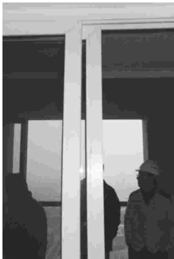
型材刚度不足变形
