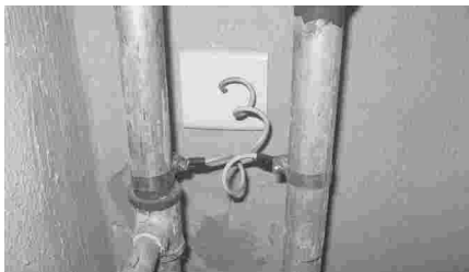
所有金属管线均应连接到等电位端子箱上
