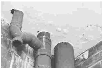
顶面脱皮、起泡
