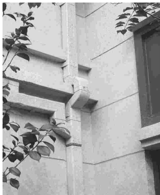
外墙排水管、冷凝管与墙体同色
