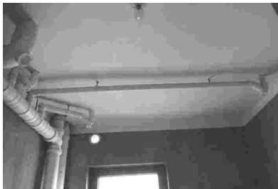
错误：卫浴间顶棚排水横管没有设置坡度
