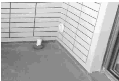
穿阳台的冷凝管坡度合理, 无遮挡
