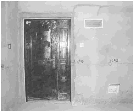
正确：室内没有安装入户门门套线
