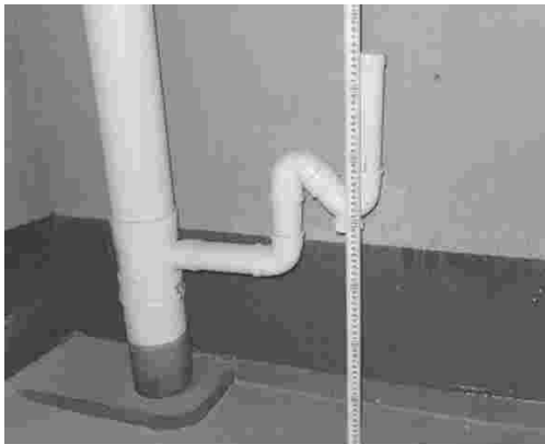
错误：水槽排水管口设置过高（超过 150mm）
