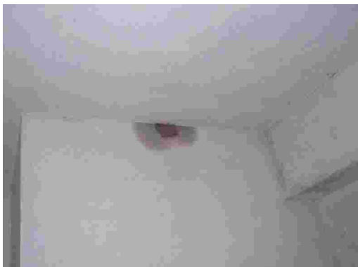
图 4-42 室内顶面渗水部位
