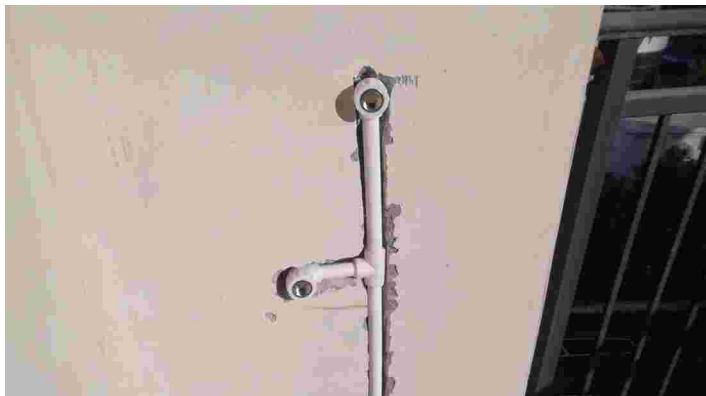
图 4-43 在外墙上开设管槽会破坏墙面防水层或防潮层
